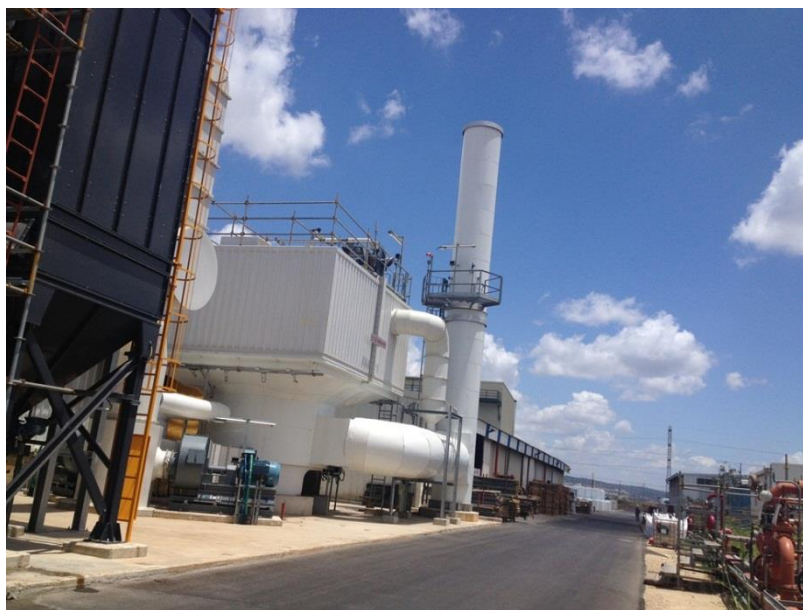
מתקן RTO בהקמה במפעל כאוו"ל
